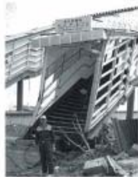
津波によって押し曲げられた 路線橋 山元町 坂本駅
