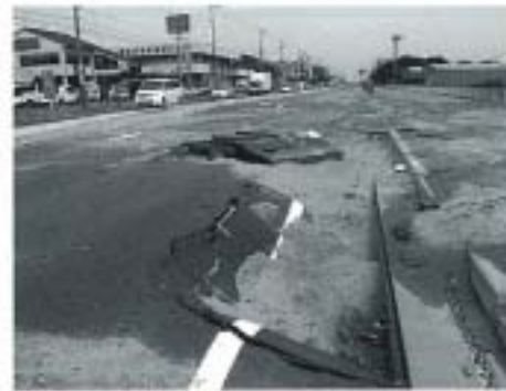
液状化によって破壊された日立市内の国道245号 線
