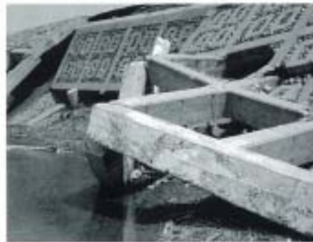
津波の越水によって陸側が崩壊した防波堤 (名取市)
